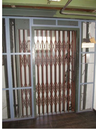
Imagem 4: Elevador de serviço usado para ir nos seis andares do Theatro São Pedro.
