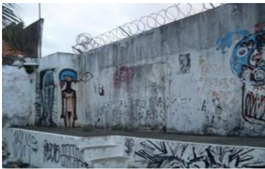
Figura 1: Muro com pichações e grafites na Rua Chile 6 .
