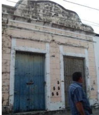
Figura 11: Prédio com cores desgastadas na Rua Chile.
