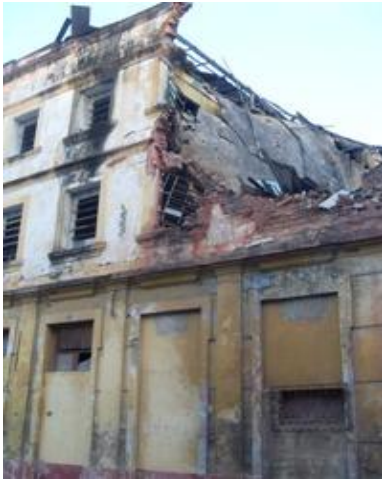
Figura 4: Prédio em ruínas na Rua Chile.
