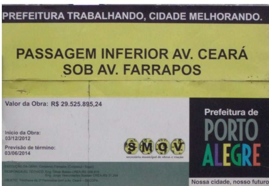
Fotografia 4: placa de obra no cruzamento com a av. Ceará Fonte: acervo do autor
