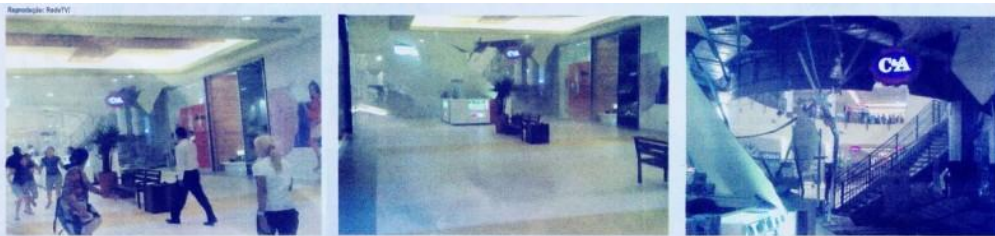
Susto: um forte estalo, o estrondo e a queda violenta de parte do teto de gesso ao chão, provocaram correria, gritos e a fuga desesperada de consumidores e evacuação do público dos cinemas
